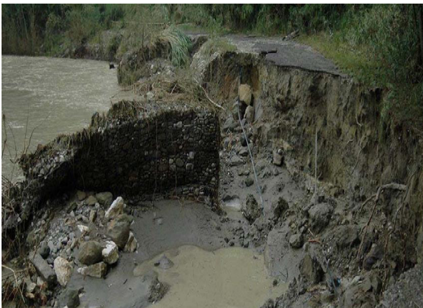
Figura 6-2: Conseguenze di evento alluvionale nel bacino del Santerno (Fonte foto: LIFE PRIMES Technical Application Form).
